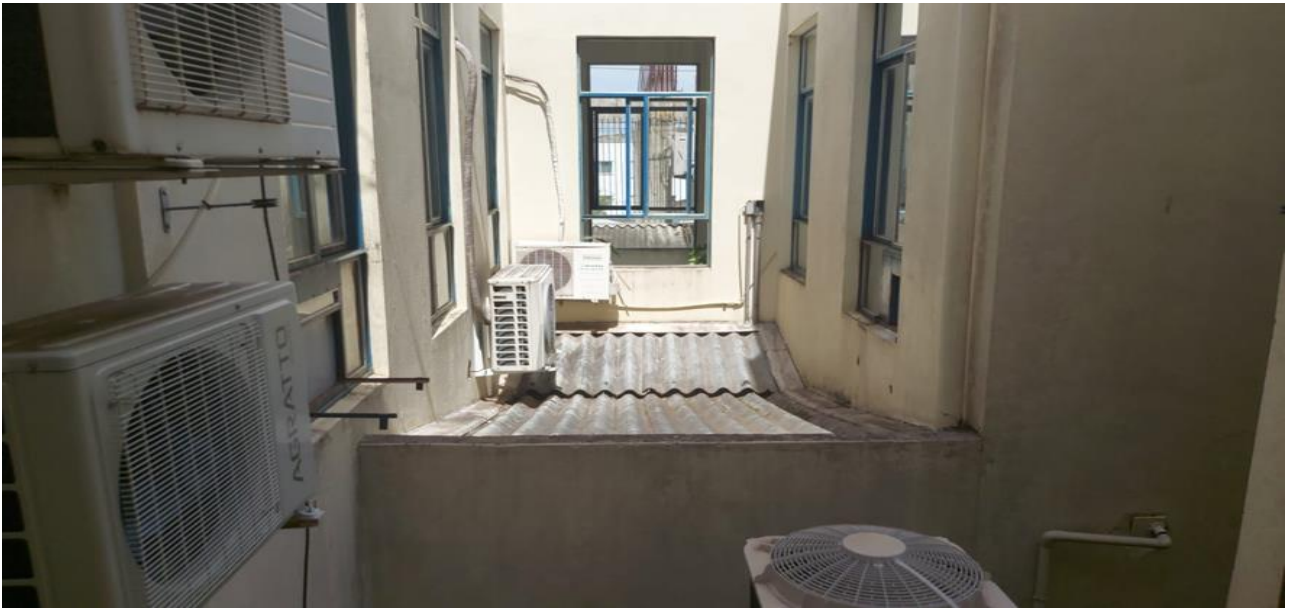
Lote 1 – Unidade externa Sala Redator de Atas.
